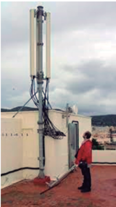
Figura 10: Mastil sobre azotea
