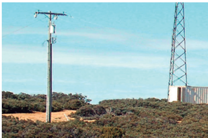
Figura 11: Antena en poste de energía
