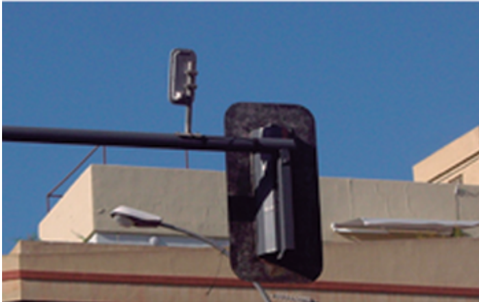
Figura 40: Picocelda instalada en semáforo y en fachada
