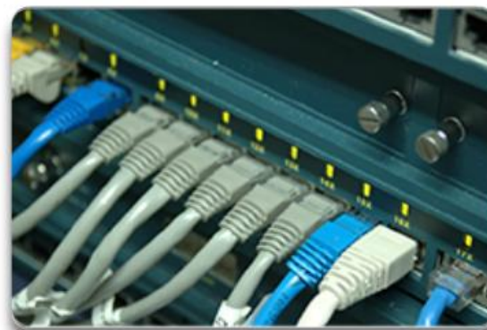
Los cables deben estar conectados correctamente.
