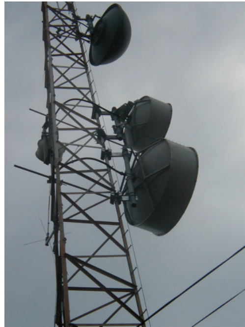
B. Torre con antenas de microondas.
